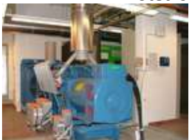
Notstromanlage für ein Krankenhaus in Österreich
