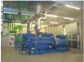
Notstromanlage für ein Krankenhaus in Österreich 1 x 450 kVA
