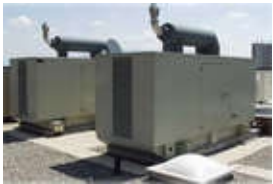
Notstromanlage für einen Pharmazeutischen Betrieb 2 x 2500 kVA
